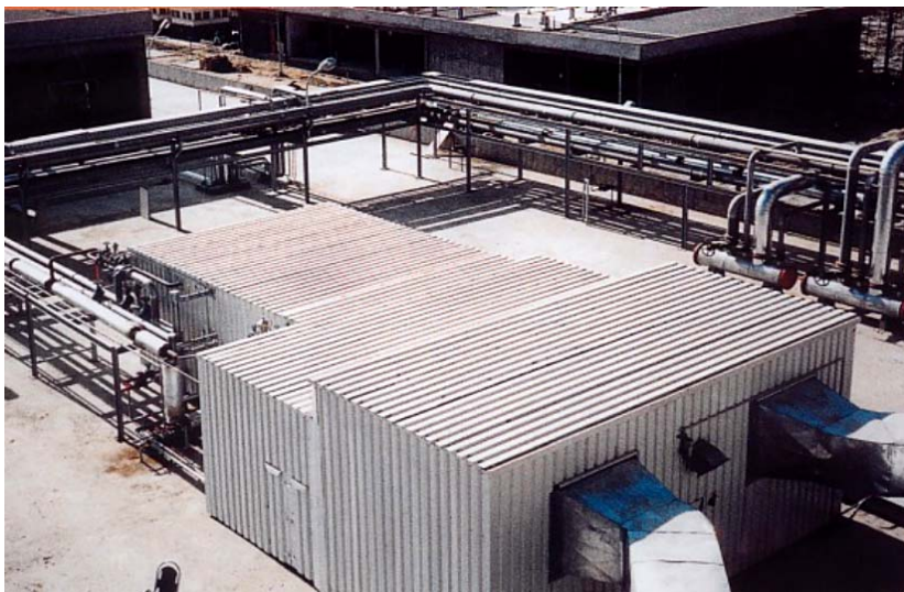
Dachzentrale einer Textilfabrik in Pakistan
